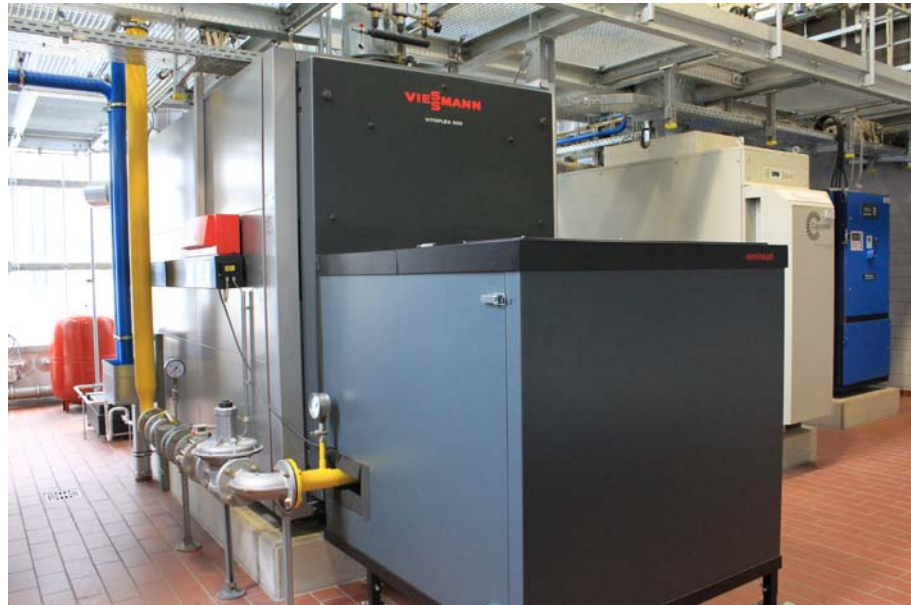
Abbildung 3: Brennwertkessel der Hochschule Offenburg von 2006
